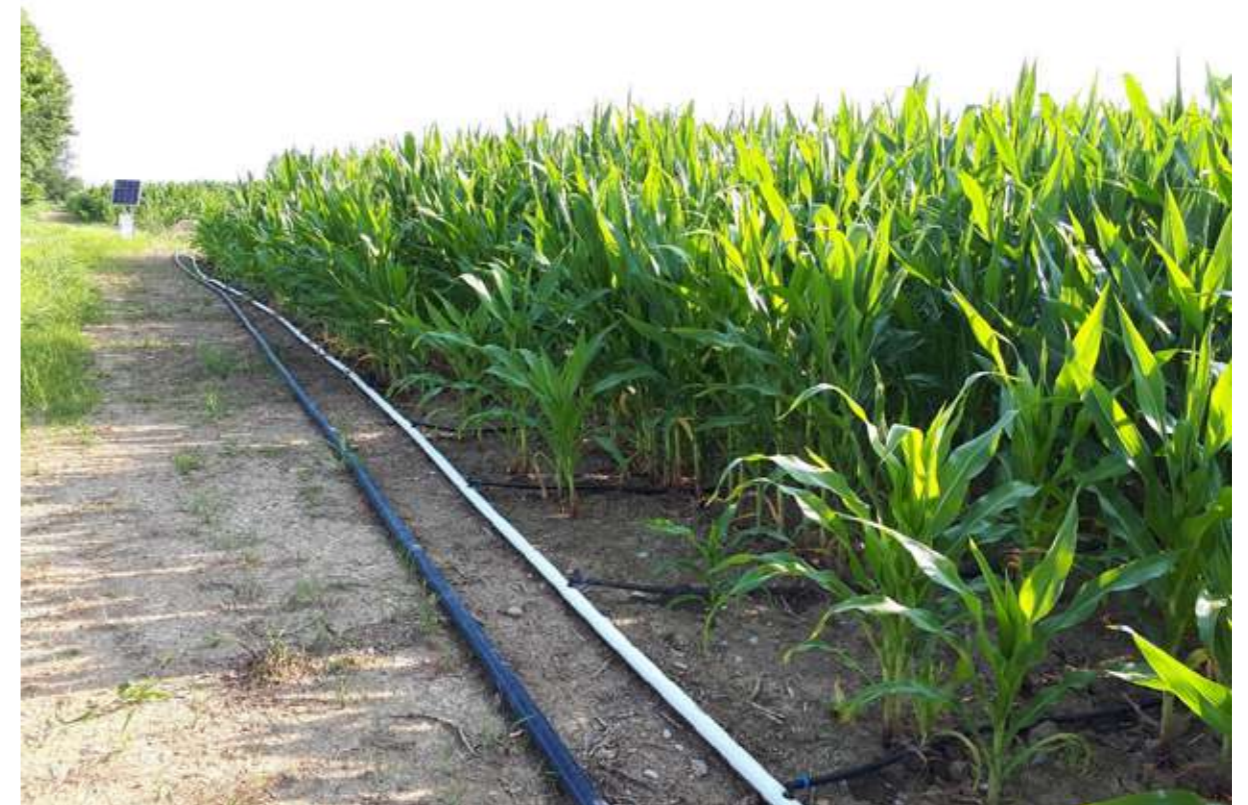
Imagen 3.13. Instalación de riego por goteo para fertirriego con fracción líquida de digerido en Lombardía (Italia).
