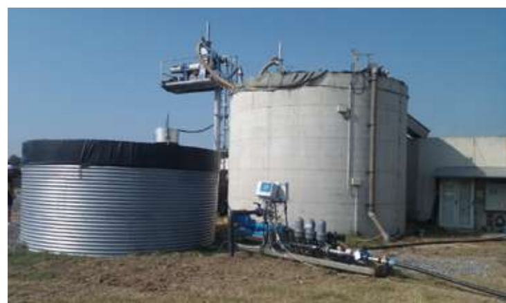
Imagen 3.7. Inyección directa de fracción líquida de digerido en el sistema de riego de una parcela desde el depósito de almacenamiento.
