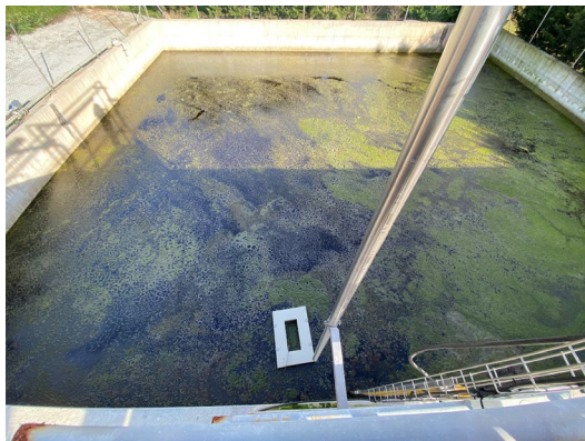
Depósito de efluentes
