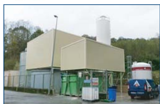
EDAR 350 m 3 /h
