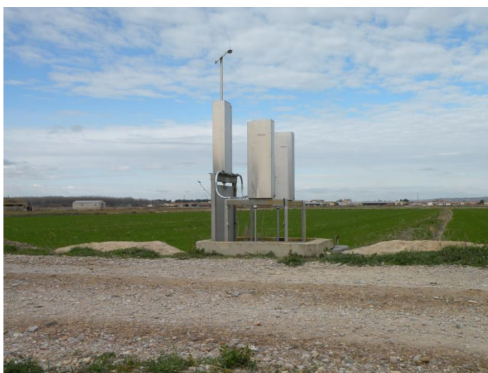
ILUSTRACIÓN 1 PROTOTIPO DE AUTOMATIZACIÓN DE ARQUETA CON TRES COMPUERTAS (RADIO LORA)
