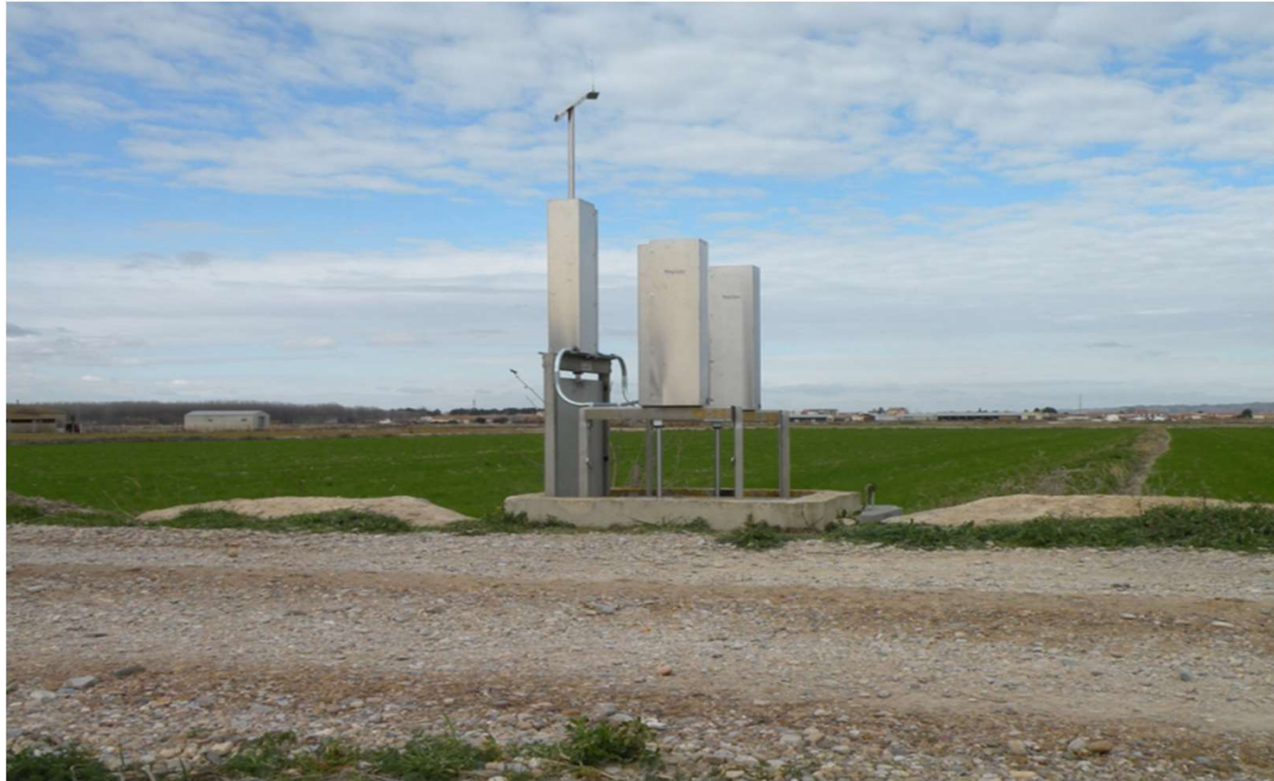
PROTOTIPO DE AUTOMATIZACIÓN DE ARQUETA CON TRES COMPUERTAS (RADIO LORA)
