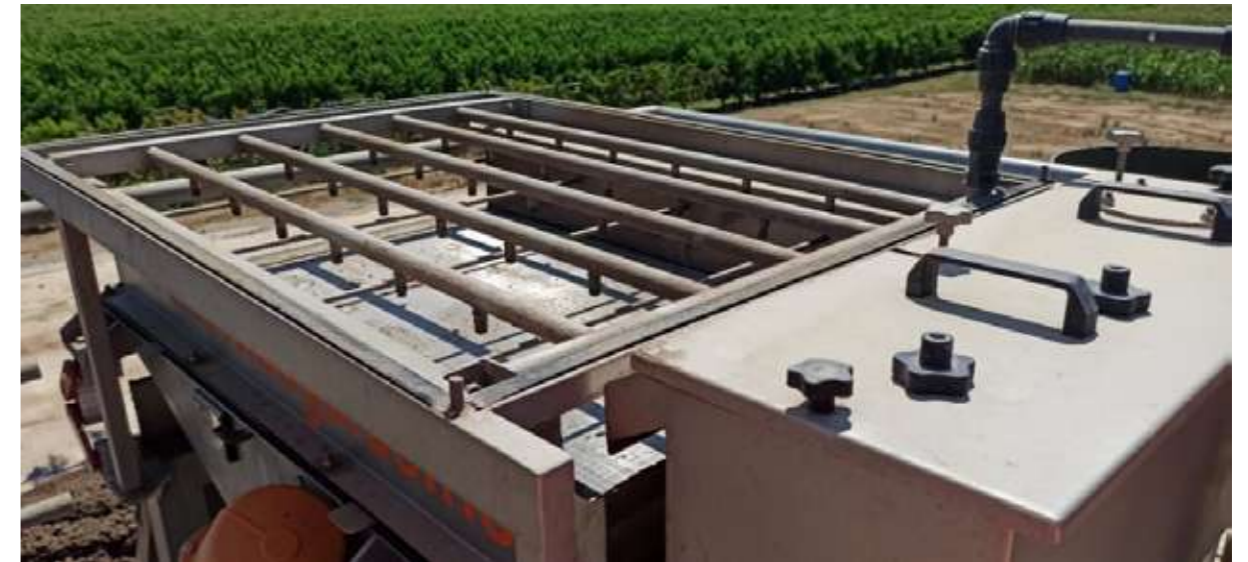
Foto 3.5. Sistema di pulizia automatica installata su un vibrovaglio.
