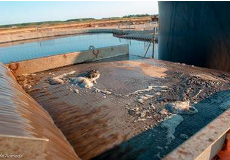
Foto 3.3. Separatori vibranti per liquame (a sinistra) e digestato (a destra).
