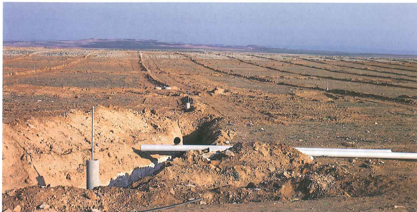
Instalación de una cobertura total de aspersión en una parcela de La Loma de Quinto de Ebro.
