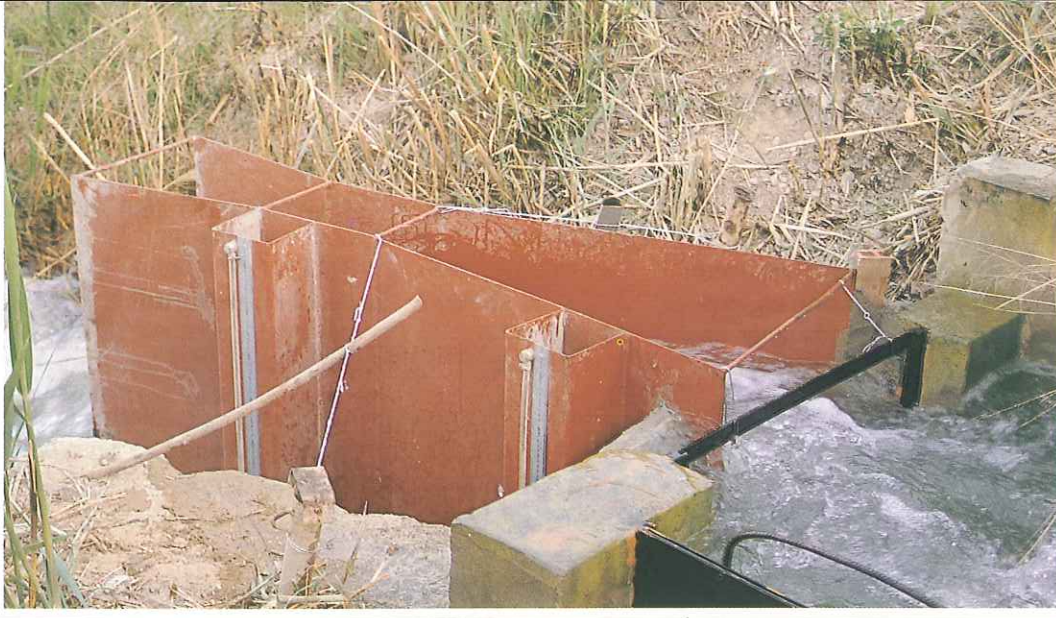
Medidor de caudal instalado en la entrada de agua a una parcela de riego.
