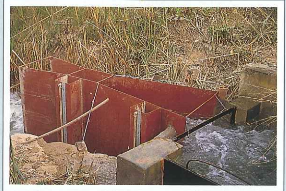
Medidor Parshall instalado en la entrada de agua a una parcela.
